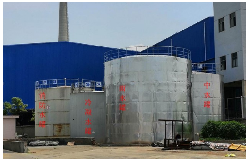
消防水罐、冷凝水罐、雨水罐、中水罐
