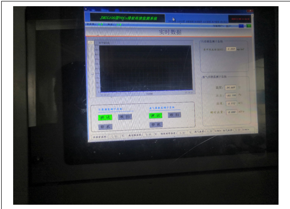
图 3.2.1-3 有机废气在线监控装置
